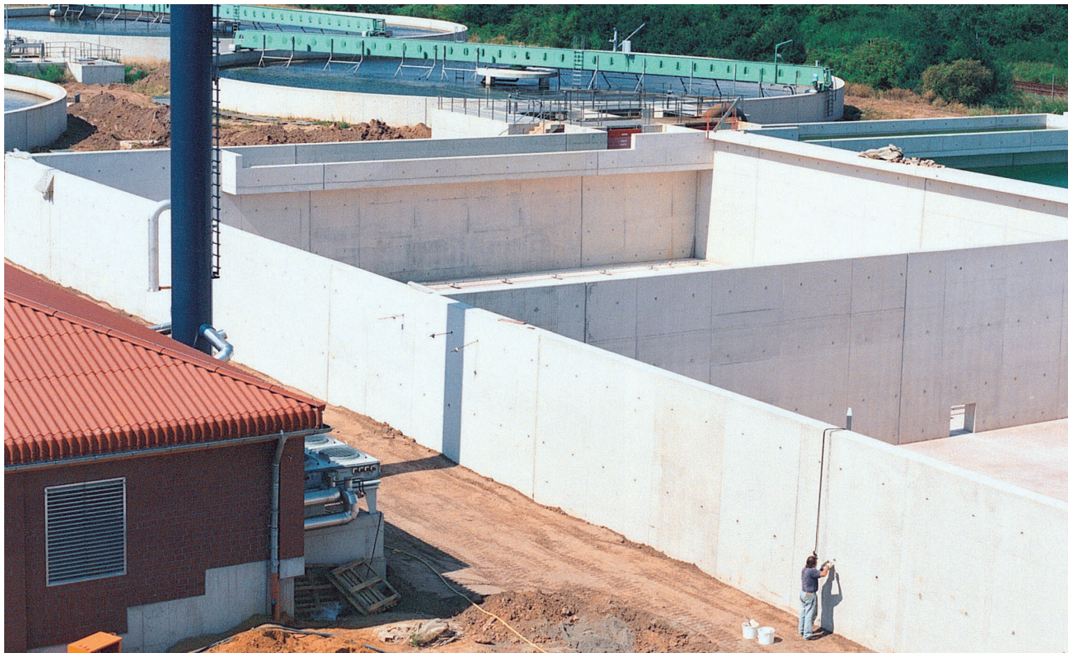
Postrojenje za prečiščavanje odpadnih voda, Hameln, Nemačka.
